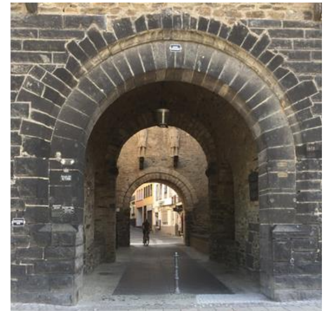
Hochwassermarken am Rheintor in Andernach
