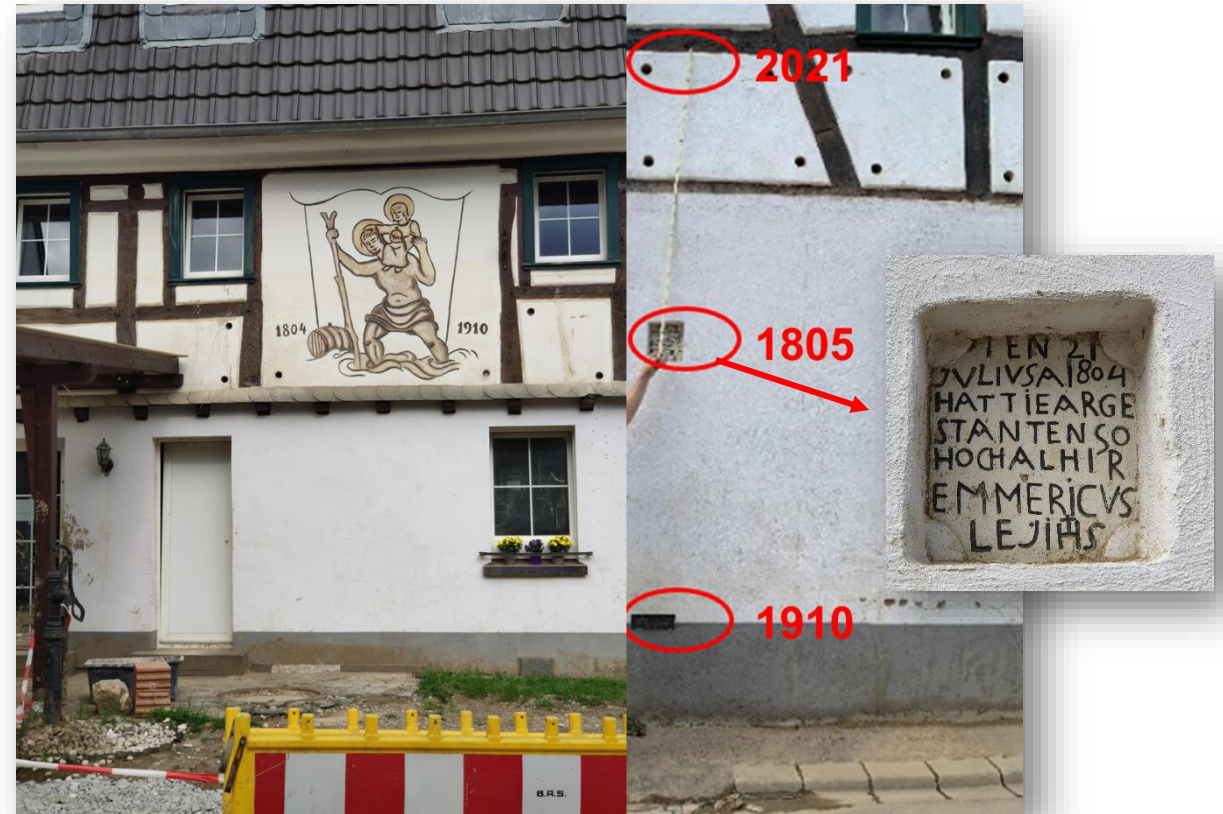
Hochwassermarkierungen an einem Haus in Walporzheim im Ahrtal (Quelle: B. Thiebes 2021)
